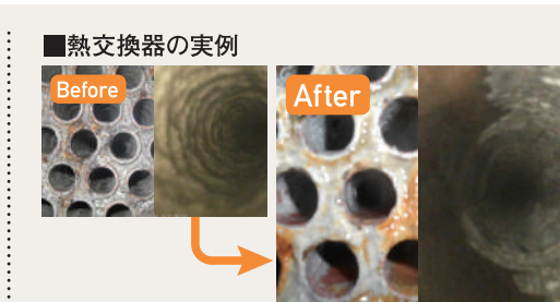
スケールが付着した熱交換器(シェル・チューブ)とチューブ内部。emiiR設置後、チューブ内のスケールが剥離。
