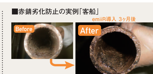
赤錆が付着した客船の厨房の排水管。排水管が黒錆化を果たし、スケールも剥離。
