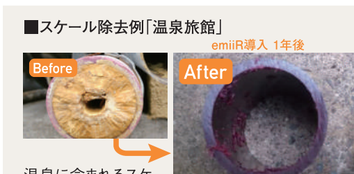
温泉に含まれるスケール成分(主にCa・Si)により、通常1年で塩ビHT管が閉塞。配管を抜管して確認したところ、スケールの付着は見られなかった。
