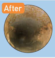
After 排水管の 尿石の剥離を確認。
