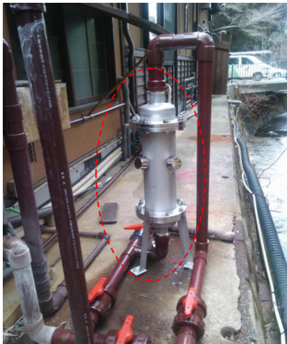
原泉供給ポンプ後に設置
