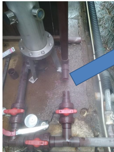
設置11ヶ月後に配管を切断
